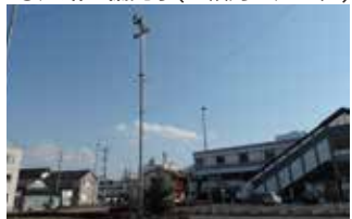
●防災無線の設置(霞ヶ関駅北口)
